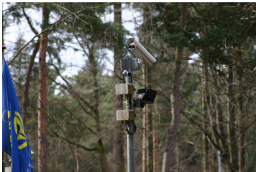
Figuur 13 Verlichting en camera op parkeerterrein Tulip Inn Epe
